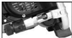
Doprowadzenie wody otwarte (dźwignia zaworu ułożona równolegle)
