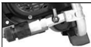
Doprowadzenie wody zamknięte (dźwignia zaworu ułożona prostopadle)
